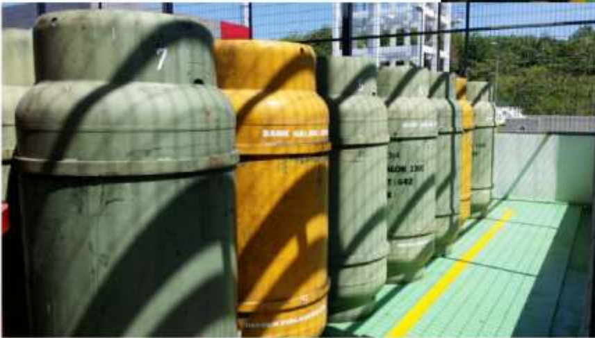
TABUNG PENGUMPUL (BULK TANK) YANG MENYIMPAN GAS HALON
