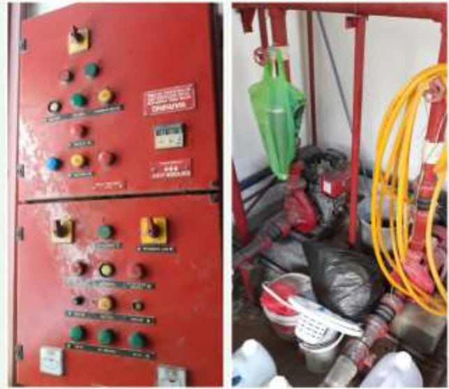
Gambarajah 2: Sistem Pemasangan Keselamatan Kebakaran tidak diselenggara
