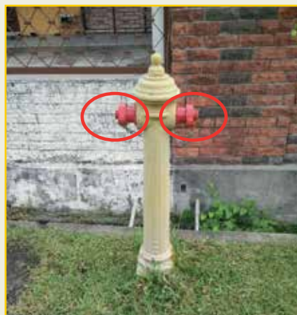
Pili Bomba yang kehilangan elbow setelah dibuat penggantian
