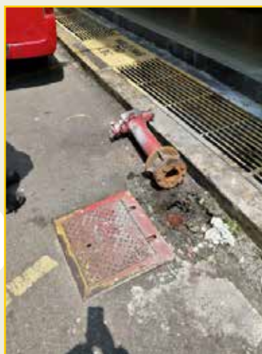
Aduan kerosakan Pili Bomba akibat dilanggar
